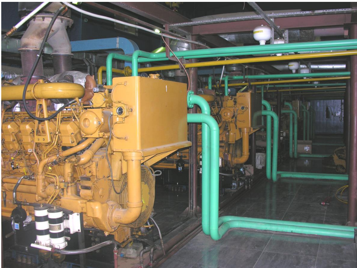
На дизельной электростанции
